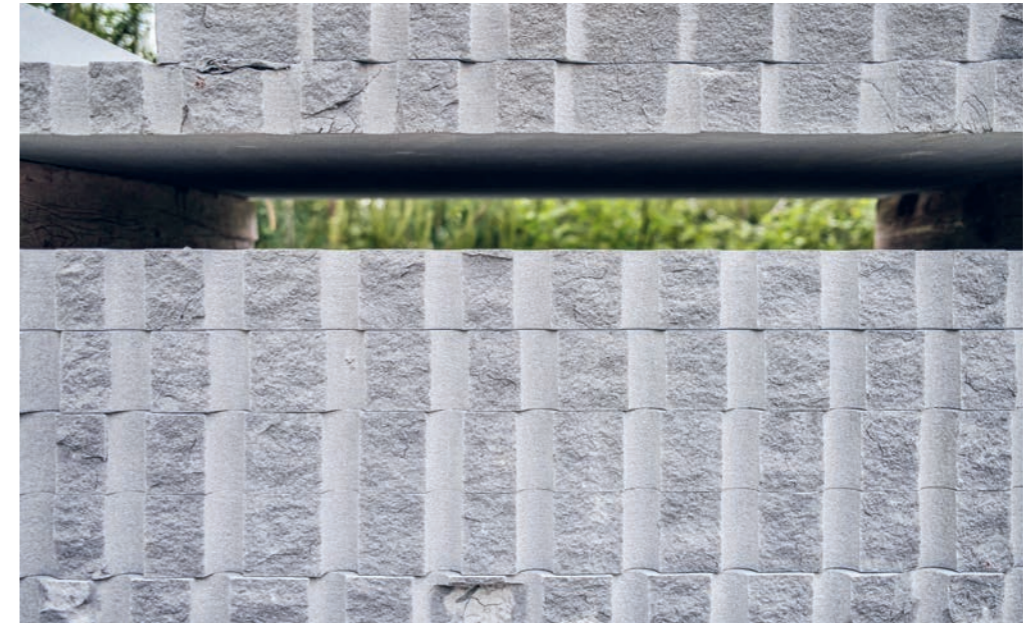
Unmassplatten, Kante mit Bohrlöchern
