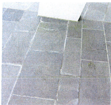
Schaden eines Belags aufgrund der Verwendung eines ungeeigneten Verlegesystems
